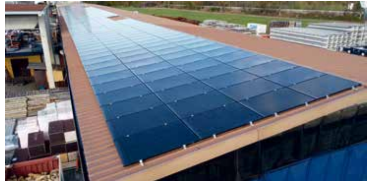
Das Werksgelände in Penning mit der neu installierten Photovoltaikanlage. (Fotos: Klebl)
